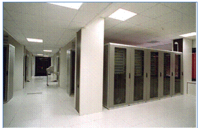
Figura: Immagine della struttura data center
